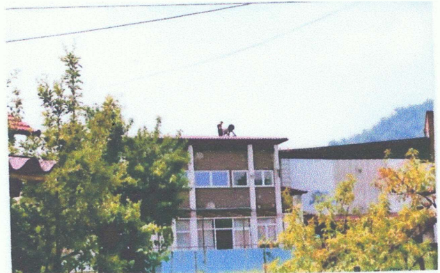
Aufbau der Wasseranlage auf dem Dach der Kommunalverwaltung
